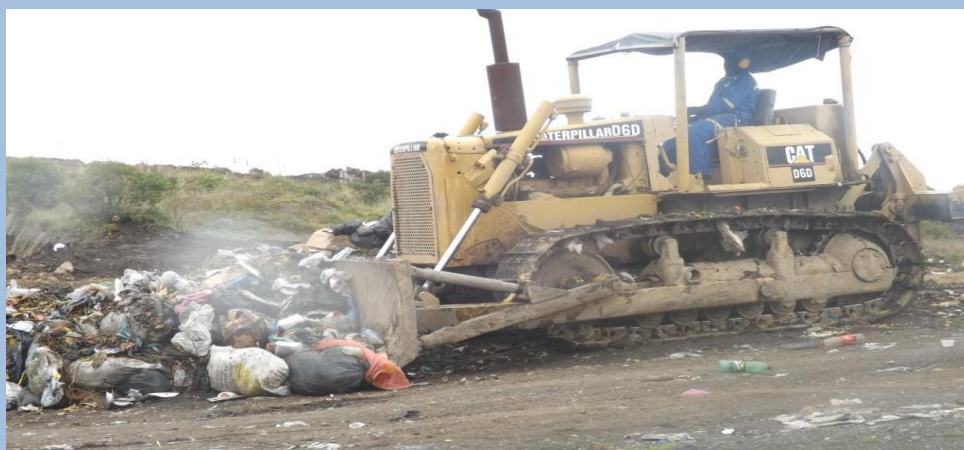
Trabajos de compactación y cobertura de los residuos sólidos Fecha: 19 de Julio del 2017 (Segunda Plataforma)
