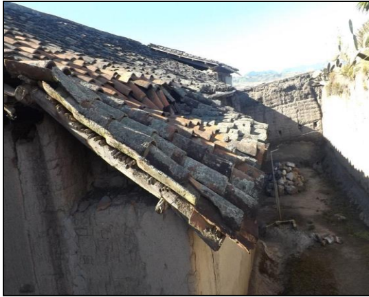
Techo de teja en mal estado
