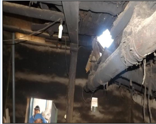
Vigas de madera en mal estado
