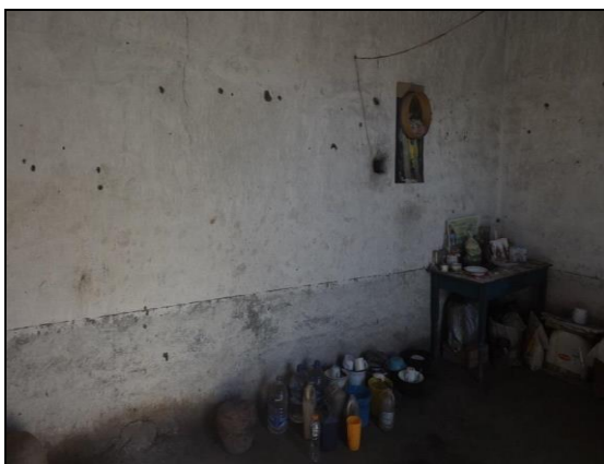
Desprendimientos en las paredes
