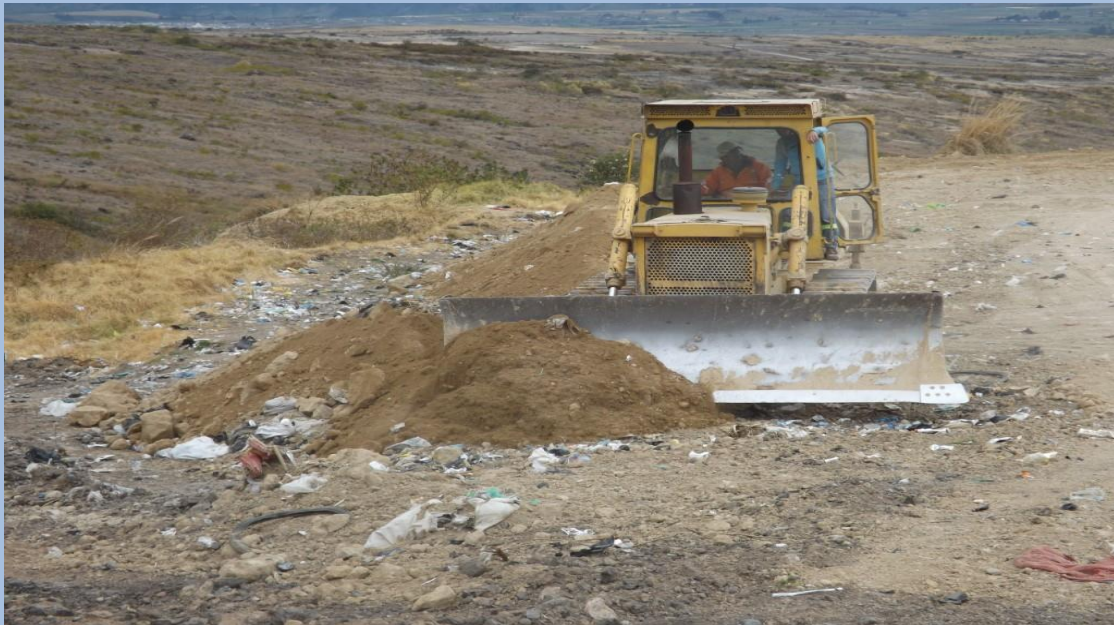
Trabajos de cobertura de los residuos sólidos Fecha: 11 de Diciembre del 2019 (Segunda Plataforma)
