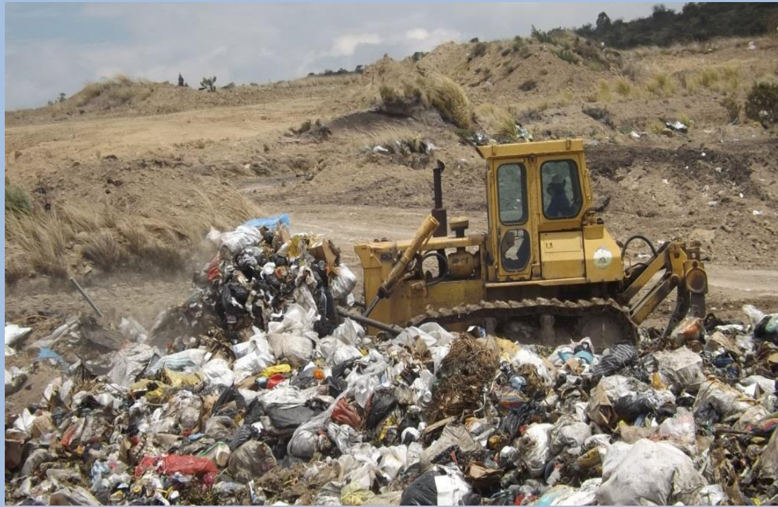
Acopio de material de cobertura de los residuos sólidos Fecha: 17 de Noviembre del 2020 (Segunda Plataforma)
