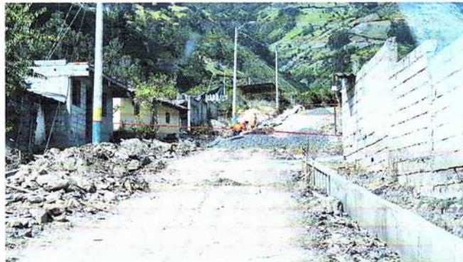
- Fotografía 4.- Se calcula la cantidad de material que se va a utilizar en cada tramo a construir para evitar desperdicios.
