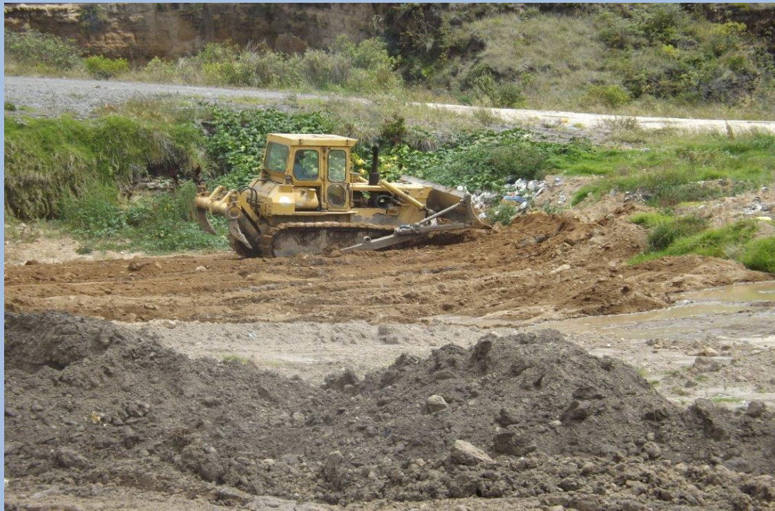
Trabajos de empuje, compactación y cobertura de los desechos sólidos Fecha: 18 de Marzo del 2021 (Segunda Plataforma)
