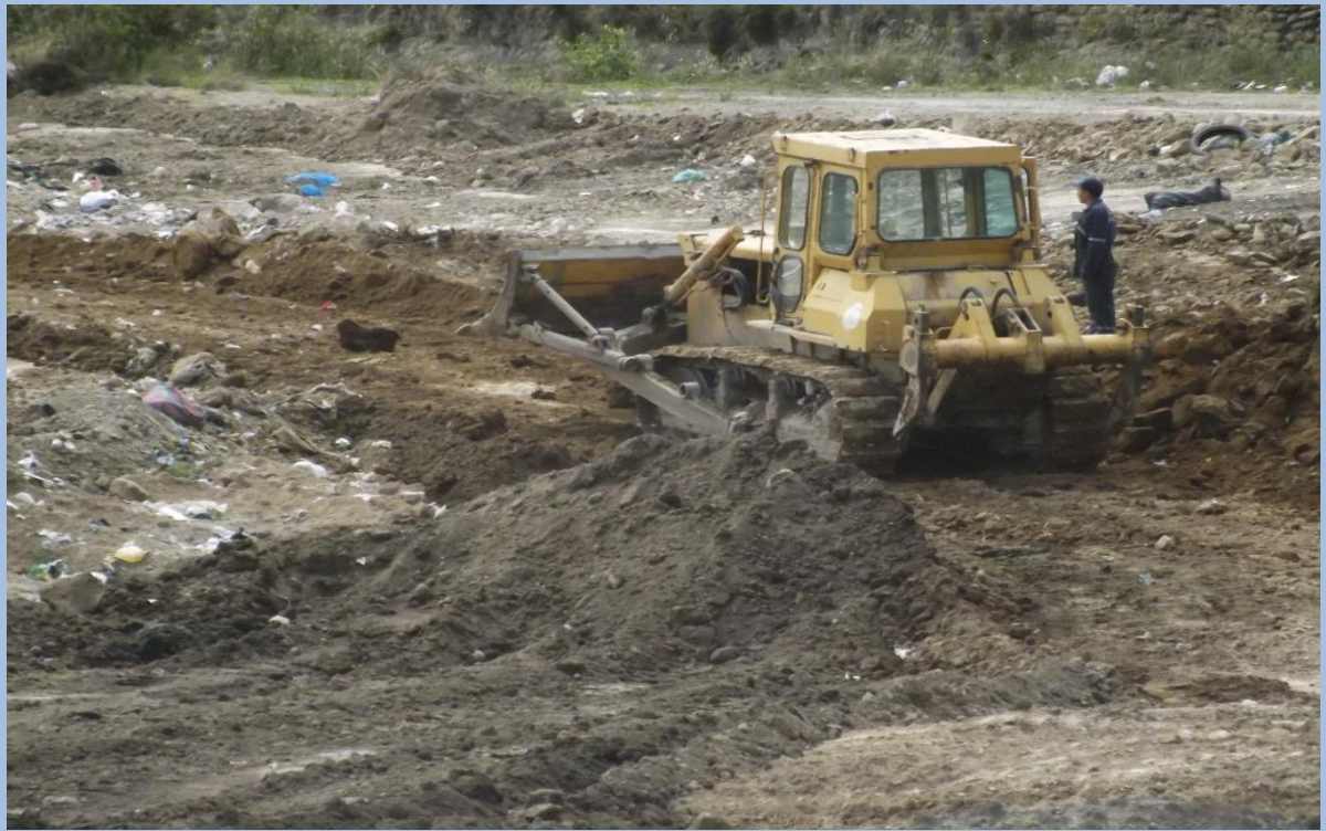
Trabajos de empuje, compactación y cobertura de los desechos sólidos Fecha: 14 de Abril del 2021 (Segunda Plataforma)
