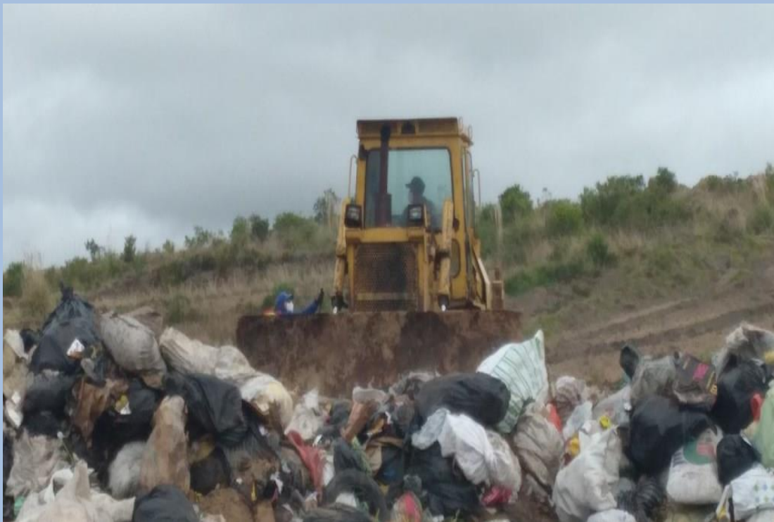
Trabajos de empuje, compactación y cobertura de los residuos solidos Fecha: 19 de Mayo del 2021 (Segunda Plataforma)
