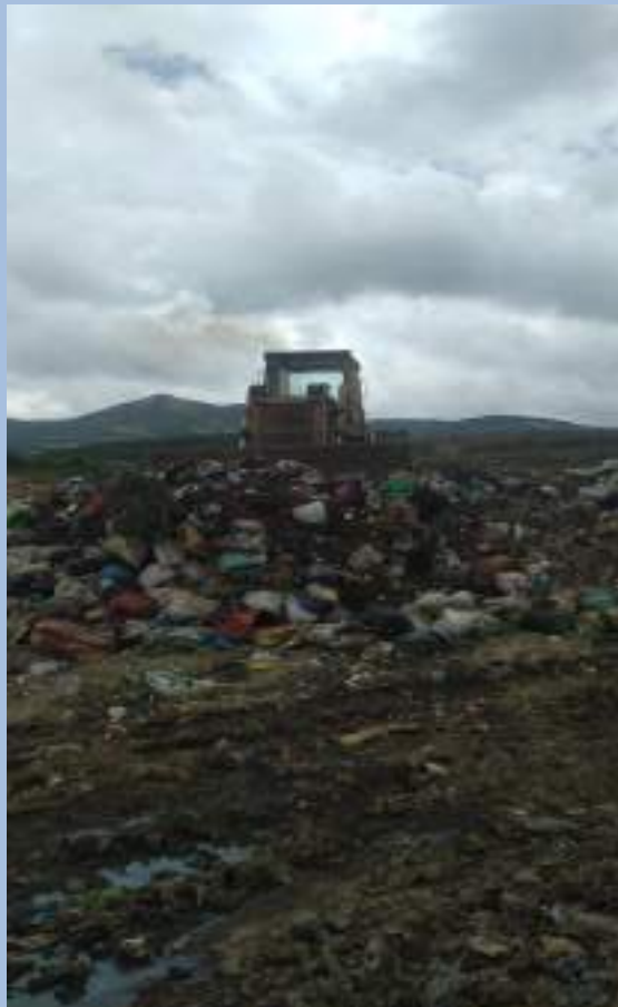
Trabajos de empuje, compactación y cobertura de los desechos sólidos Fecha: 16 de Marzo del 2022 (Segunda Plataforma)
