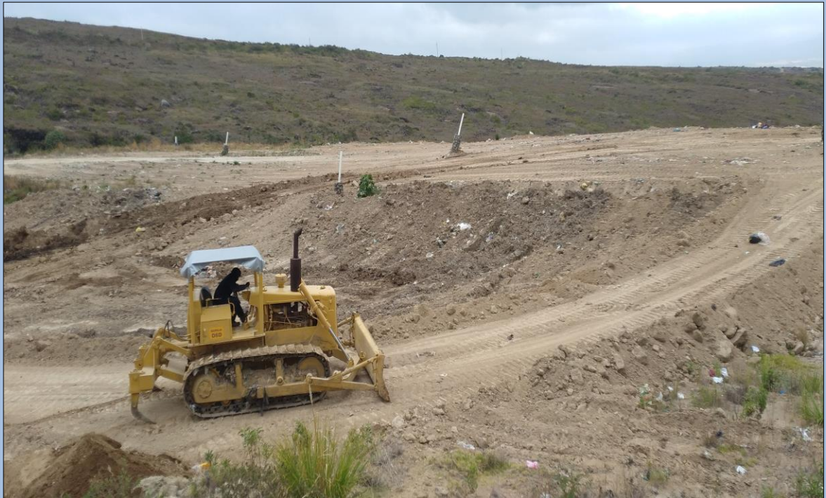
Trabajos de empuje, compactación y cobertura de los desechos sólidos Fecha: 14 de Septiembre del 2022 (Segunda Plataforma)
