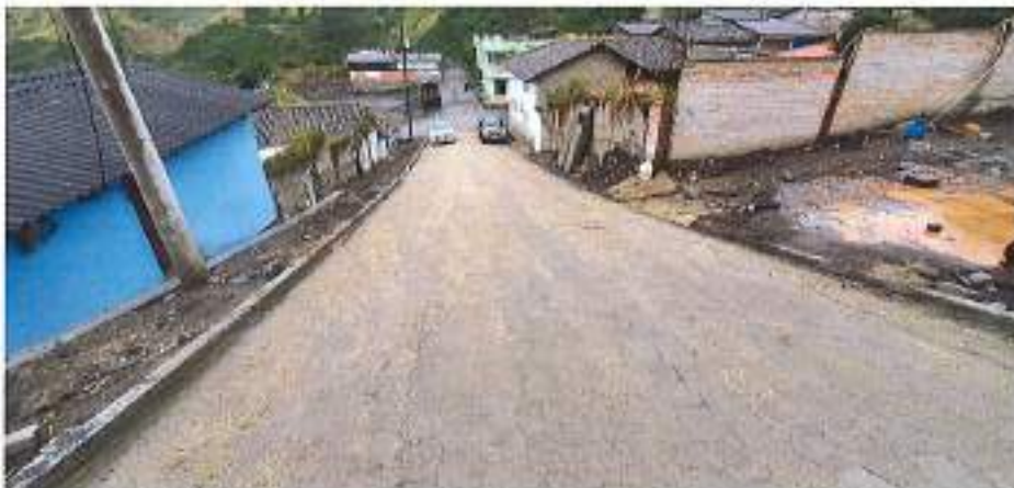
- Fotografía 8.- Se realiza la limpieza de la obra una vez que se han terminado todos los trabajos dispuestos por fiscalización. (2022-10-21)
