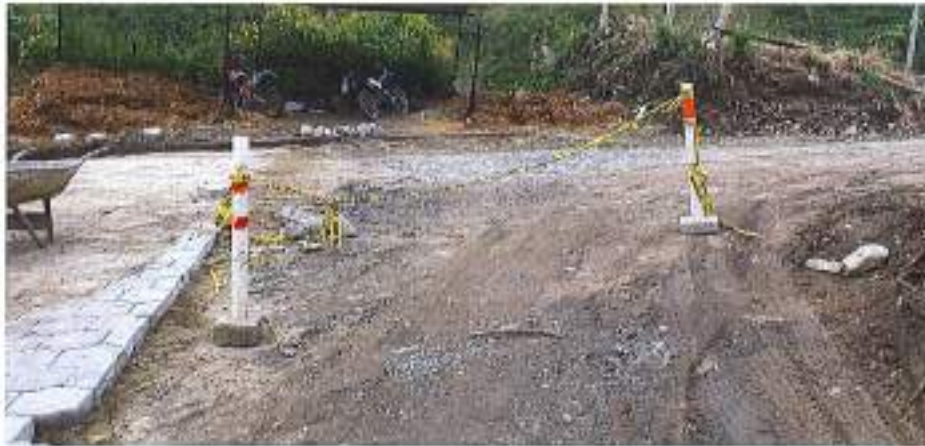
- Fotografía 7.- Se advierte del peligro a los usuarios de la vía (2022-09-29)
