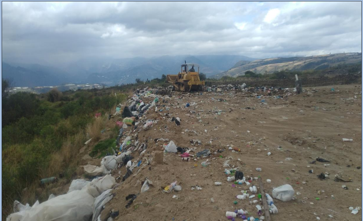
Trabajos de empuje, compactación y cobertura de los desechos sólidos Fecha: 11 de Octubre del 2022 (Segunda Plataforma)
