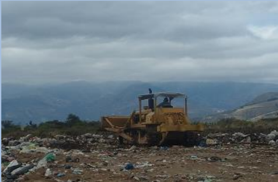
Trabajos de empuje, compactación y cobertura de los desechos sólidos Fecha: 20 de Diciembre del 2022 (Segunda Plataforma)
