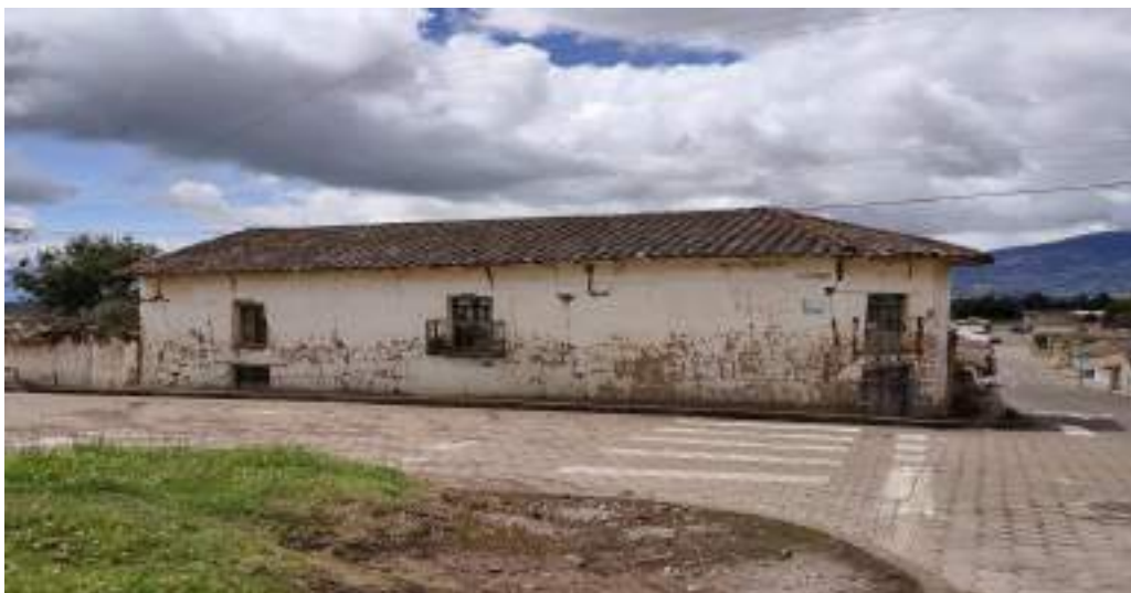
Imagen 11. Vivienda en mal estado.
