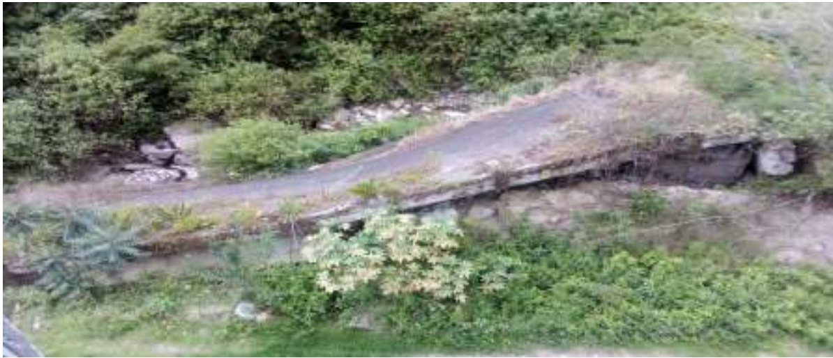
Imagen 8. Puente destruido por el aumento del caudal del río.
