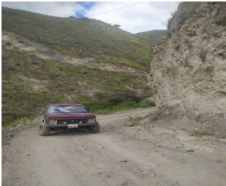
Imagen 13. Vía a la comunidad El Guitarrero, es estrecha y presenta lugares donde se desprende material que puede llegar a obstruir la vía. Fuente: Elaboración Propia
