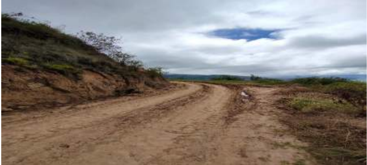
Imagen 10. Obstrucción de la vía por deslizamientos de tierra en temporada de invierno Fuente: Elaboración Propia
