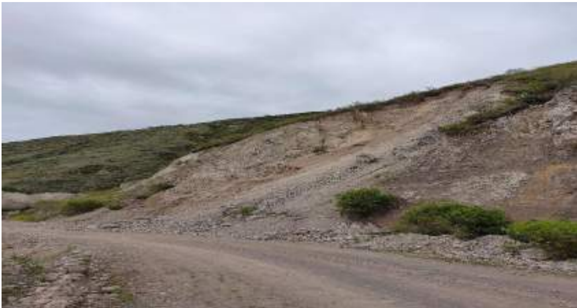
Imagen 7. Caída de tierra y material rocoso en la vía.
