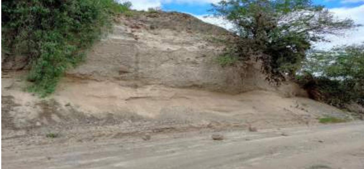
Imagen 8. Talud en riesgo derrumbe.
