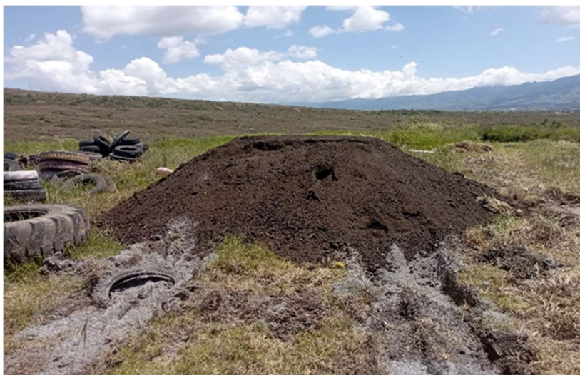
Fotografía 25 Primera Plataforma de tratamiento y disposición final de residuos sólidos finalizada
