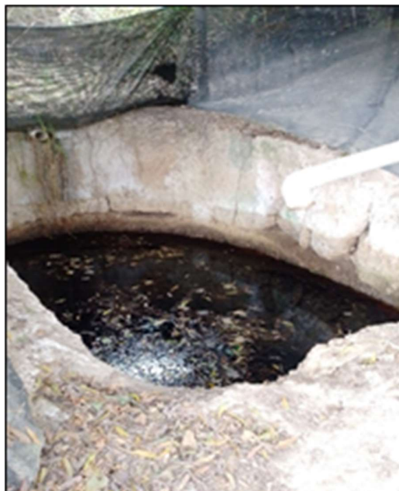
Fotografía 33 Fosa de lixiviados sin descarga
