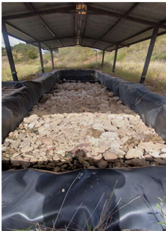
Fotografía 32 Piscina de tratamiento de lixiviados
