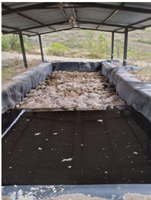
Fotografía 21 Piscina de recepción y tratamiento de lixiviados
